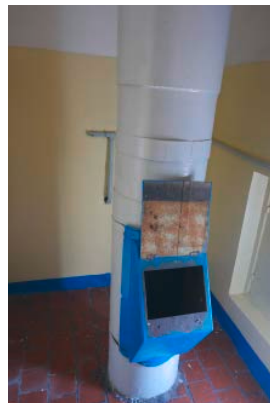
Abbildung 7 Müllschlucker in einem alten Wohnhaus, Ulaanbaatar, Juni 2018. © Joni Seager/www.grida.no/resources/13281
